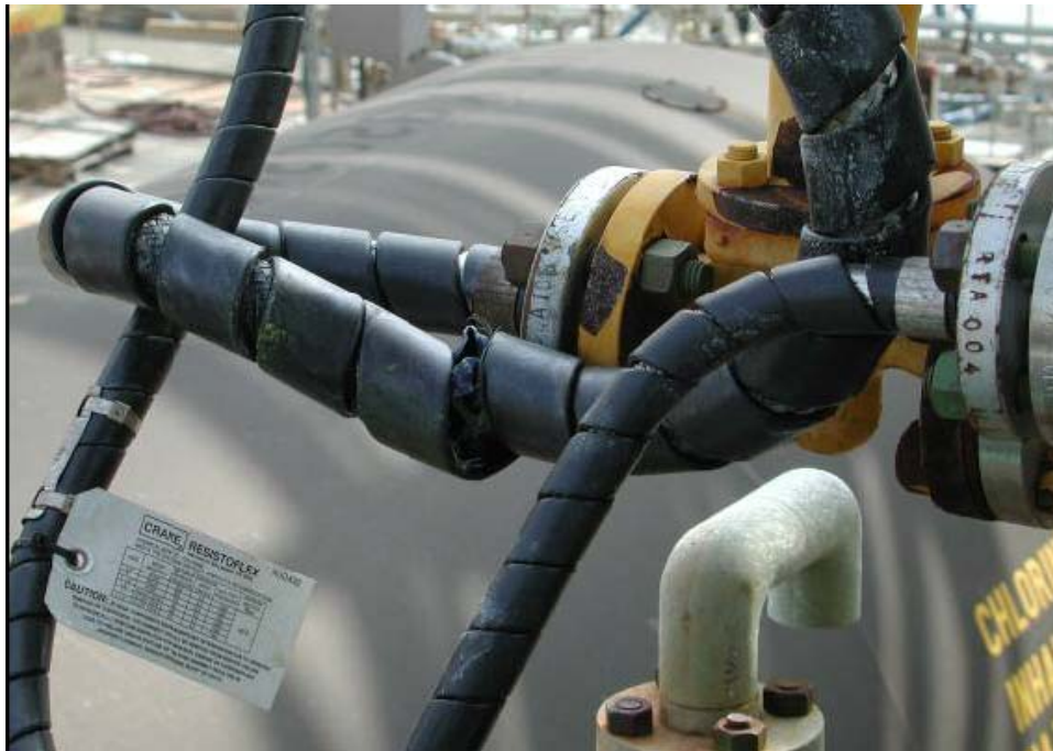
Obrázek 2 Prasklá hadice ve společnosti Honeywell
